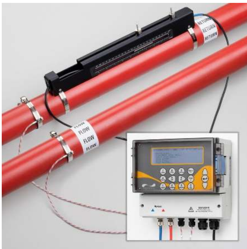
Abbildung 20 Vollständig montierter UF3300 (Wärmezähler-Modell)
